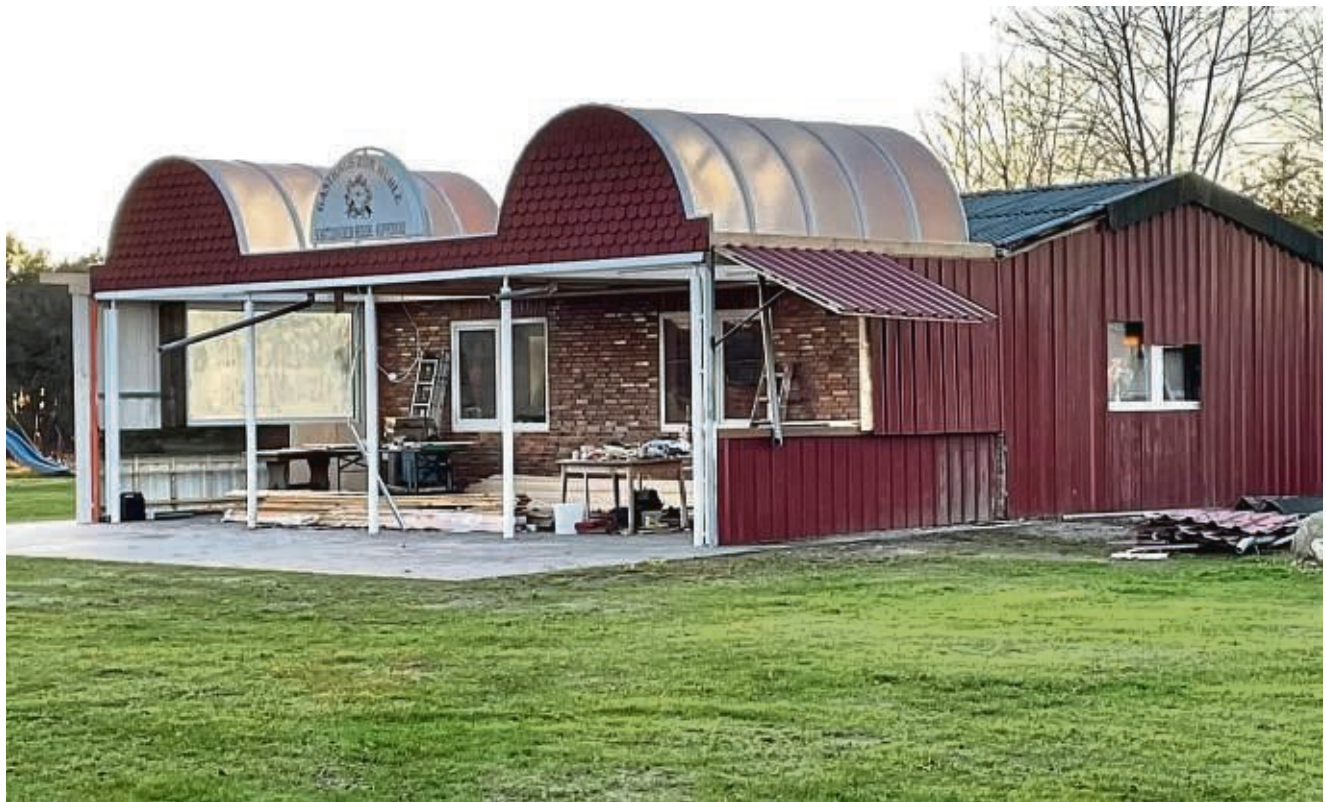
Die Arbeiten am Schützenhaus in Kuppendorf bescheren den Mitgliedern einen Unterstand im Eingangsbereich.
